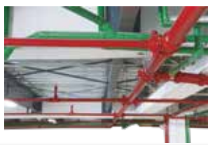
Tubería de acero para sistemas contra incendios
